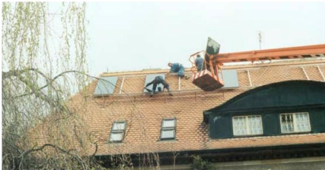
Největší místní instalace, rovněž podpořená radnicí, ohřívá vodu na dětském domově (16 plochých kolektorů). Objekt nepatří městu. Hlavní dotaci na solární systém poskytli SFŽP (foto z výstavby)
